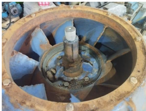
Difusor com desgaste erosivo
