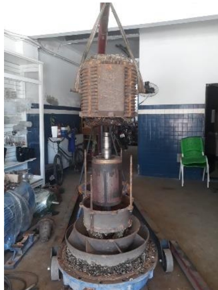
Eletrobomba impregnada de crustáceos
