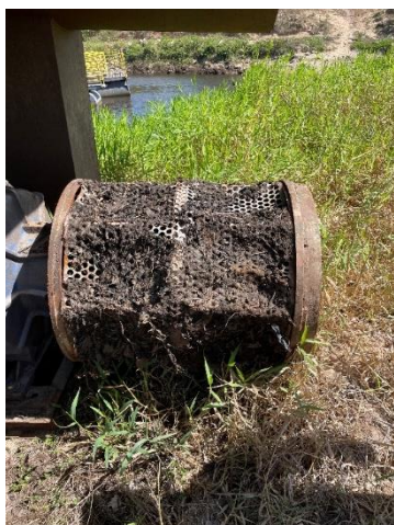
Crivo implodido devido ao gradiente de pressão
