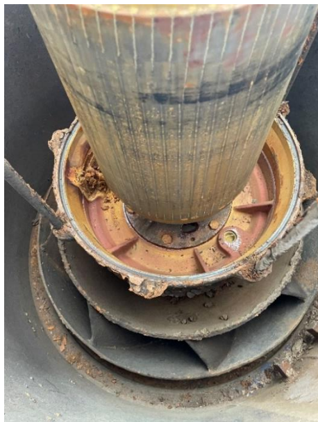
Tampa, difusor e estator oxidados
