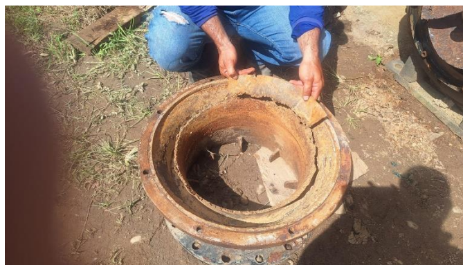
Anel de desgaste danificado por corrosão
