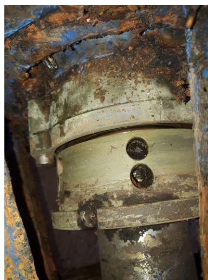
Região do selo mecânico avariado devido à corrosão
