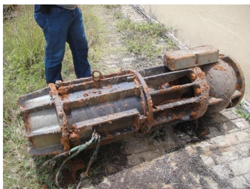
Eletrobomba submersa enferrujada
