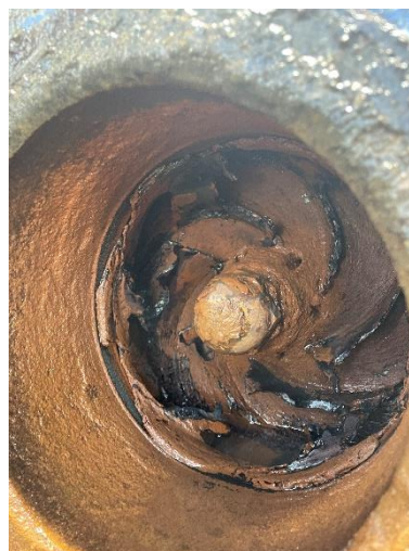
Rotor totalmente erodido
