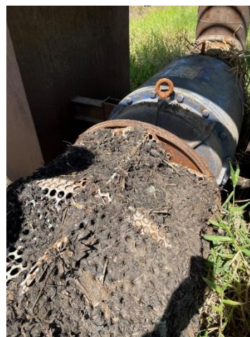
Crivo entupido devido a macrófitas
